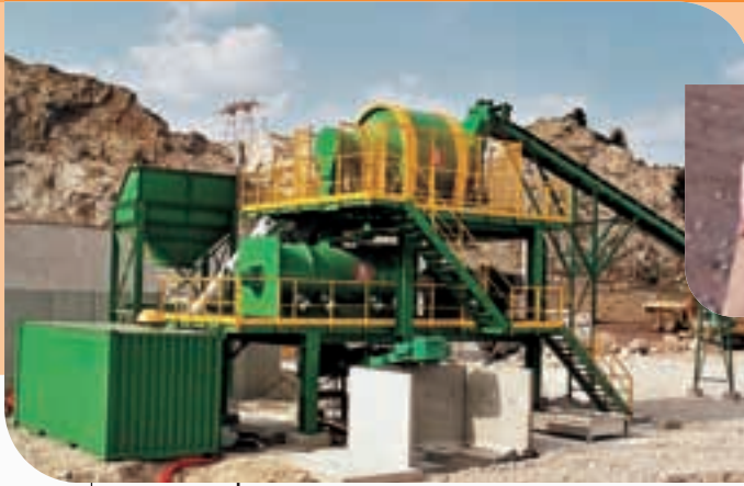
Installation complète de mélange pour la dépollution de terre contaminée
